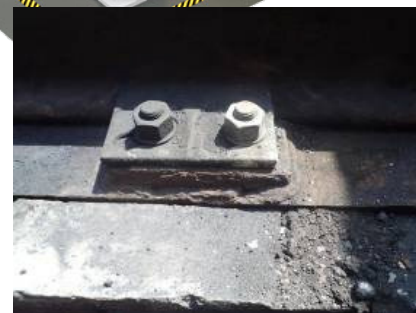
Les soudures de la tenaille à rails commencent à se corroder.
