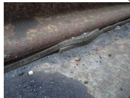
Le patin du rail n'est pas correctement installé.
